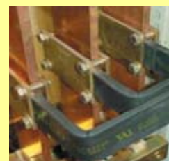
Imagen de unión de barras de cobre en tableros eléctricos
