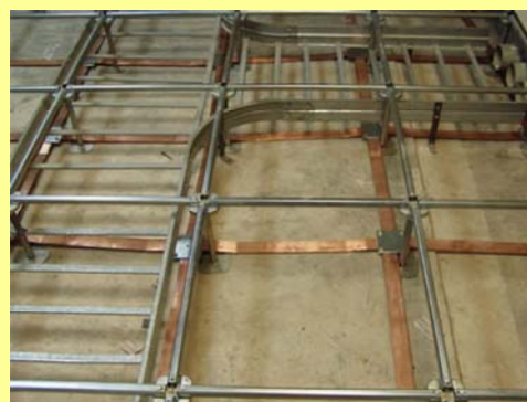
Imagen de unión de barras de cobre en mayas de aterramiento
